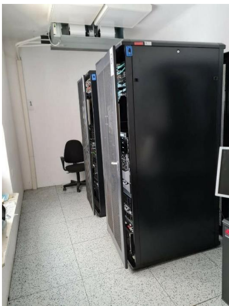
Zdjęcie nr 4: Widok na serwerownię.
